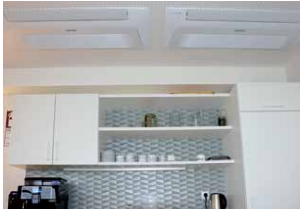
Insgesamt wurden 138 Samsung DVM 1-Wege-Kassettengeräte und sieben Samsung DVM 4-Wege-Kassettengeräte installiert.
