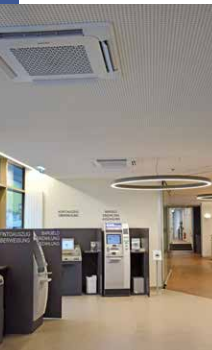
Blick in den SB-Bereich für Kunden der Bank Burgenland-Filiale in Eisenstadt (wo zwei Decken-Innengeräte bei Bedarf auch Wärme liefern).
